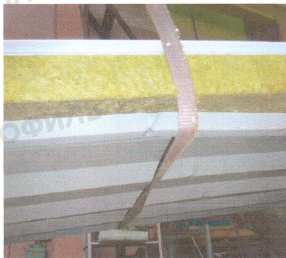
Разрушение образца №2 панели.
