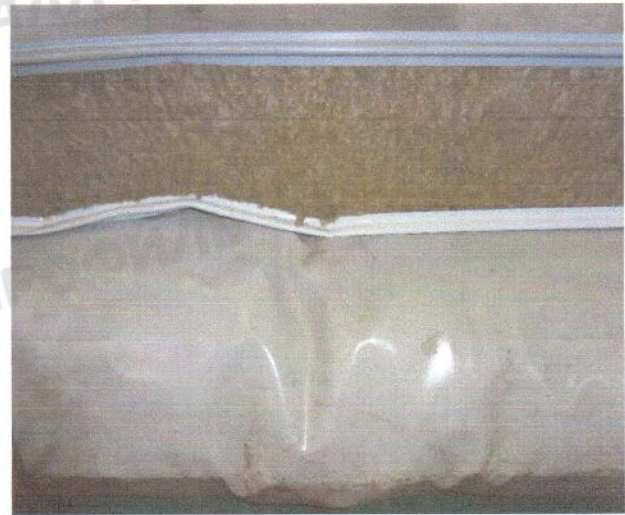
Разрушение образца №2 панели.
